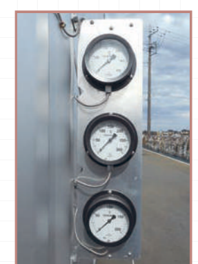
温度計 コンテナ内の上層、中層、下層の温度を計測します。
