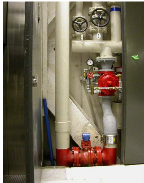
—————▶ 交換後予作動式（湿式）流水検知装置
