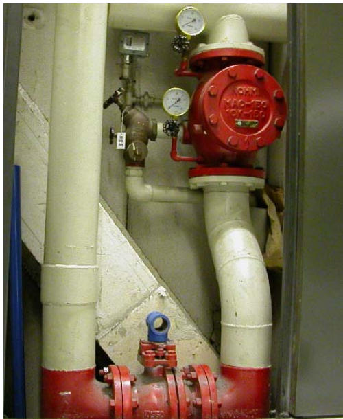
既設流水検知装置
