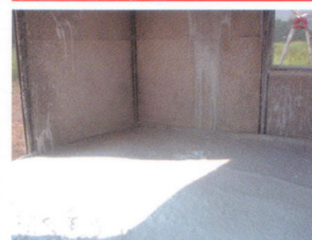
床面は泡状の消火剤で覆われ鎮火。消火後、床面に火種を近づけたが再燃せず。
