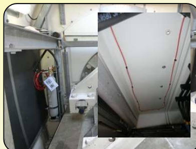
風力発電設備(ナセル内)
