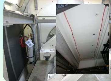
風力発電設備(ナセル内)
