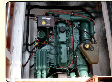
ボート エンジンルーム
