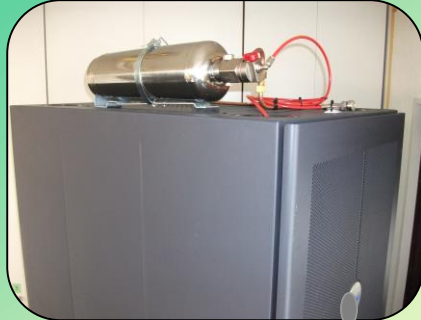
サーバーラック
