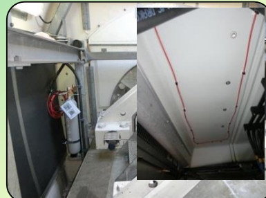
風力発電設備 (ナセル内)
