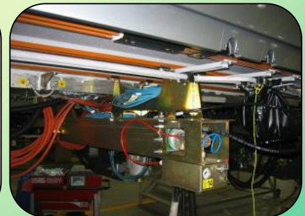
モノレール車両ブレーキ部
