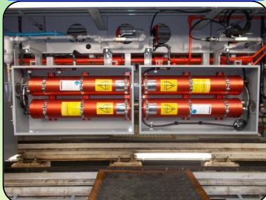
鉄道車両エンジンルーム
