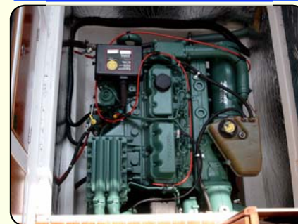
ボート エンジンルーム
