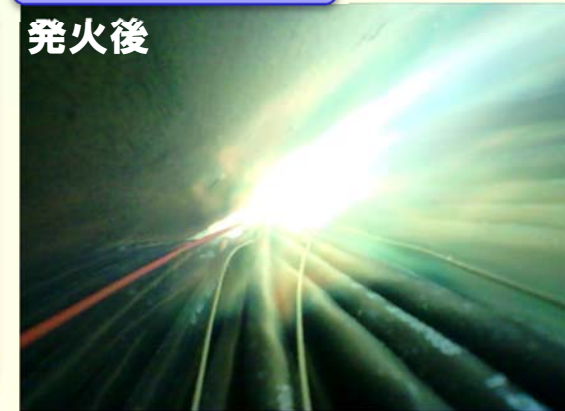
消火装置作動直後
