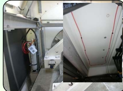
風力発電設備(ナセル内)
