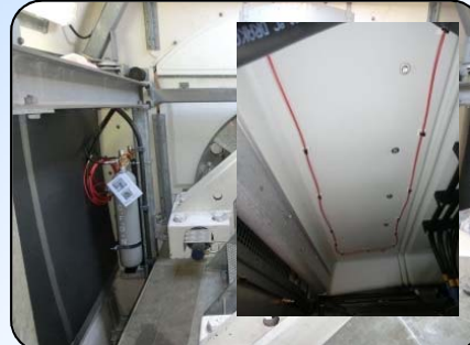
風力発電設備(ナセル内)
