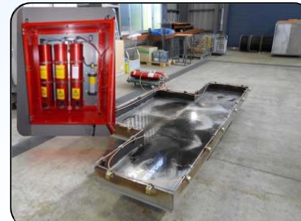
風力発電設備(タワー内)
