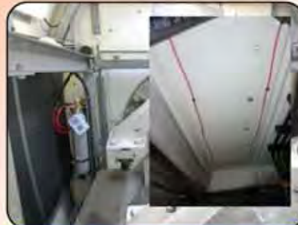
風力発電設備(ナセル内)
