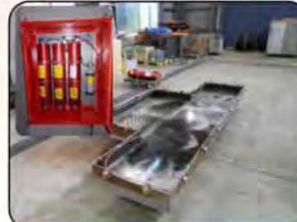
風力発電設備(タワー内)
