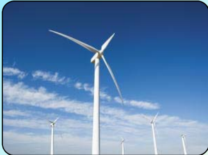
風力発電設備
