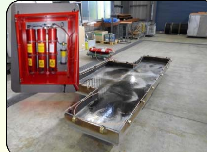
風力発電設備(タワー内)
