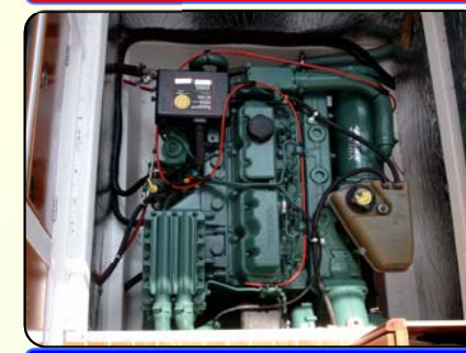
ボート エンジンルーム
