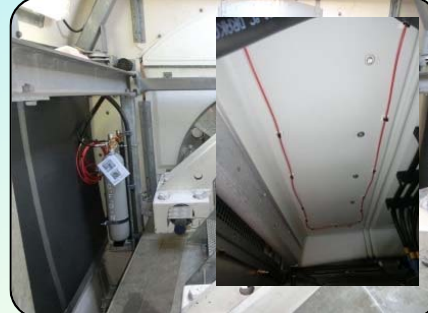
風力発電設備(ナセル内)
