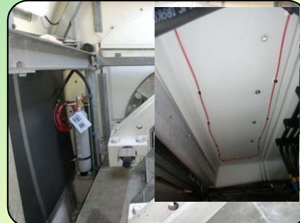
風力発電設備(ナセル内)
