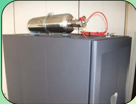
サーバーラック
