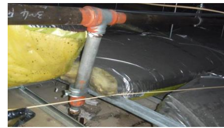
SPヘッド破損
