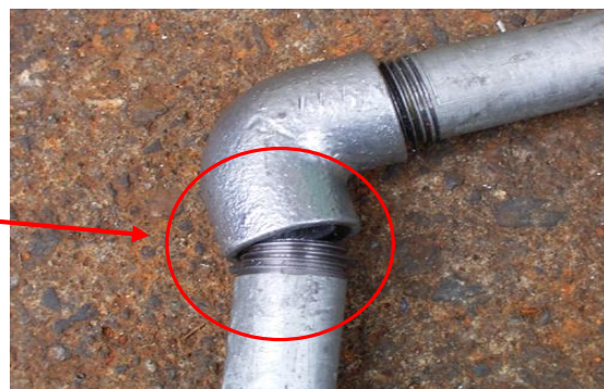
(ねじ接合部破損)
