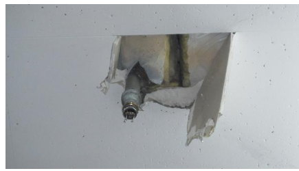
SPヘッド破損
