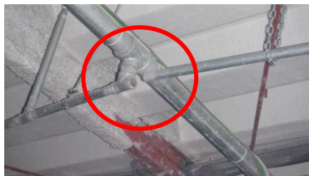
25A配管が折れてしまった
