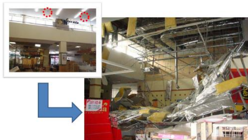
天井の落下に伴い スプリンクラー配管が破損した模様
