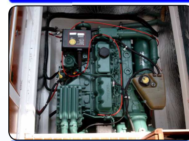
ボート エンジンルーム
