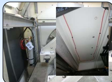
風力発電設備(ナセル内)
