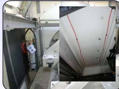
風力発電設備(ナセル内)
