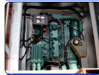
ボート エンジンルーム
