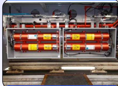
鉄道車両エンジンルーム
