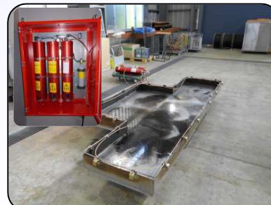
風力発電設備(タワー内)
