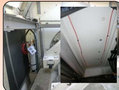
風力発電設備(ナセル内)
